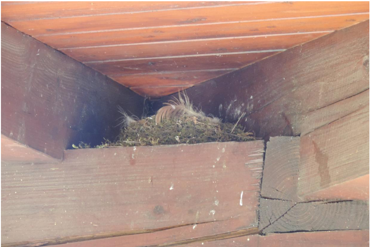
Abbildung 7: offene Balkenkonstruktion des nördlichen Gebäudeteils mit Hausrotschwanznest
