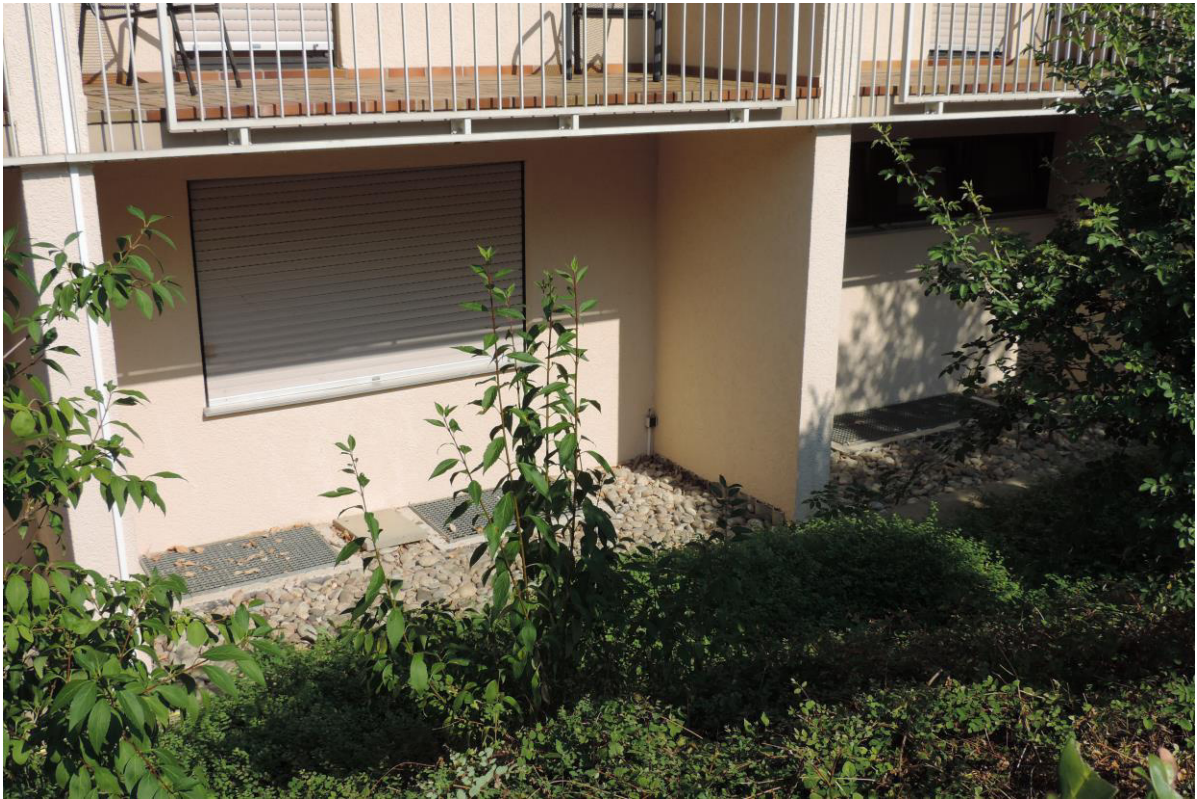
Abbildung 9: Wackenanfüllung unter Balkonen an östlicher Hausseite des nördlichen Gebäudes
